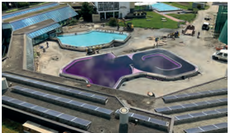
Probetrieb und Färbeversuch Thermalaußenbecken
